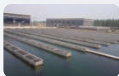
Plantas municipales de agua potable
